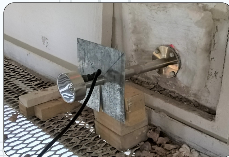
Датчик ЭКОН-ВТ, установленный в регенераторе стекловаренной печи
